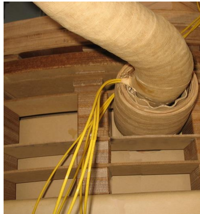
Rys. 5.19. Widok wyprowadzenia światłowodów z obszaru uzwojeń 220kV [Oprac. własne]
