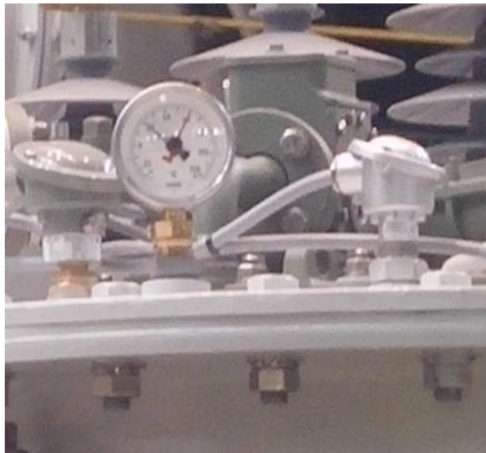
Rys. 3.12. Widok termometrów zainstalowanych na pokrywie kadzi [Oprac. własne]
