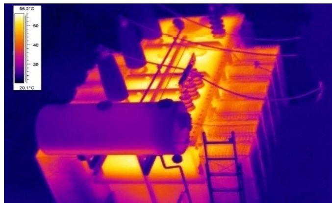
Rys. 3.15. Rozkład temperatury podczas próby nagrzewania transformatora 32MVA [Oprac. własne]
