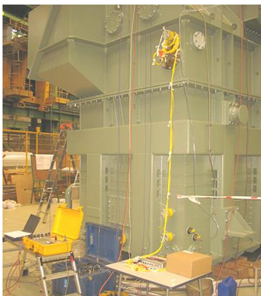
Rys. 5.25. Ogólny widok stanowiska pomiarowego temperatury punktów gorących w uzwojeniach transformatora typu TONRLa 156000/220 z użyciem czujników optycznych [Oprac. własne]
