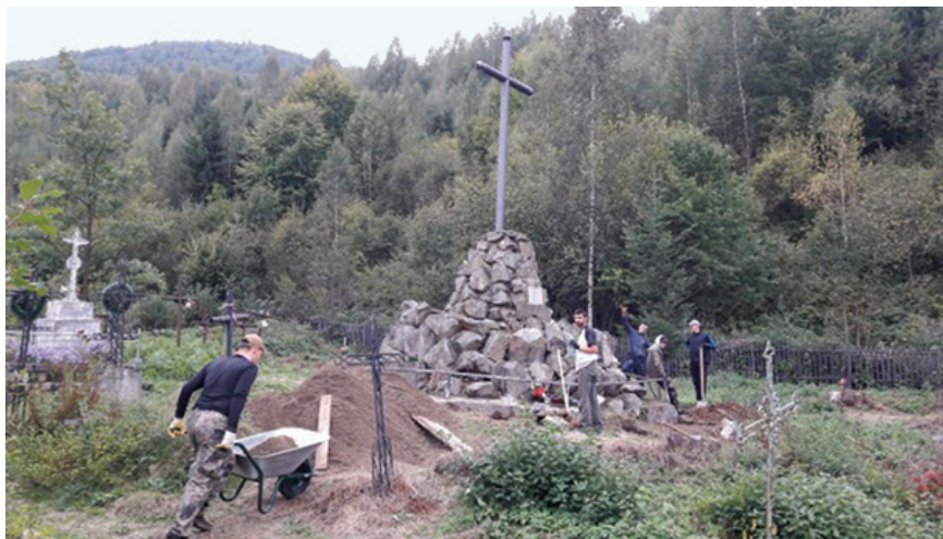
Fot. 5.6. Praca uczniów ZSG przy renowacji pomnika żołnierzy Żelaznej Brygady w Pasiecznej (obecna Ukraina)
