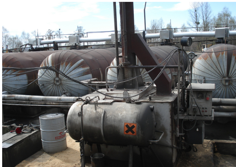
Rys. 1.4. Zestaw zbiorników do magazynowania asfaltu
