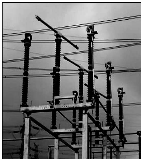
Rysunek 2.5. Odłącznik poziomoobrotowy, dwuprzerwowo z uziemnikiem na napięciu 110 kV
