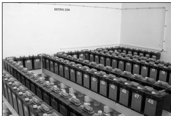
Rysunek 6.12. Bateria akumulatorów o napięciu 220 V w stacji elektroenergetycznej
