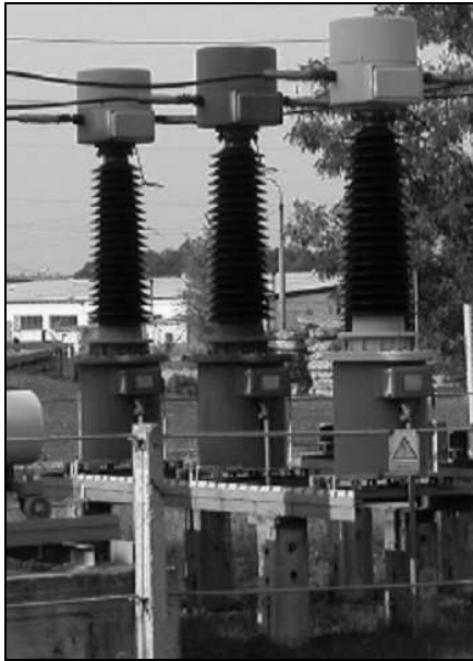
Rysunek 2.6. Przekładniki prądowe na napięciu 110 kV
