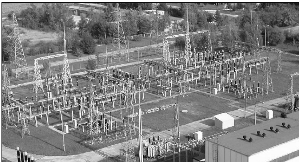
Rysunek 4.4. Rozdzielnia 110 kV w układzie z podwójnym, sekcjonowanym systemem szyn zbiorczych
