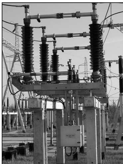
Rysunek 2.4. Odłącznik poziomoobrotowy, jednoprzerwowo z uziemnikiem na napięciu 110 kV
