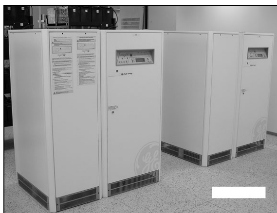
Rysunek 6.4. Zasilacze UPS firmy GE na stacji elektroenergetycznej w pomieszczeniu urządzeń teletransmisji i telefonii nośnej
