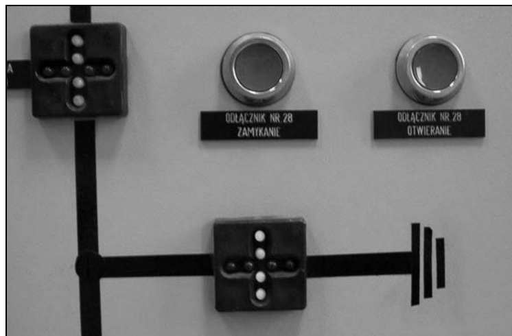
Rysunek 9.7. Diodowe wskaźniki położenia na szafie sterowniczej rozdzielni 110 kV
