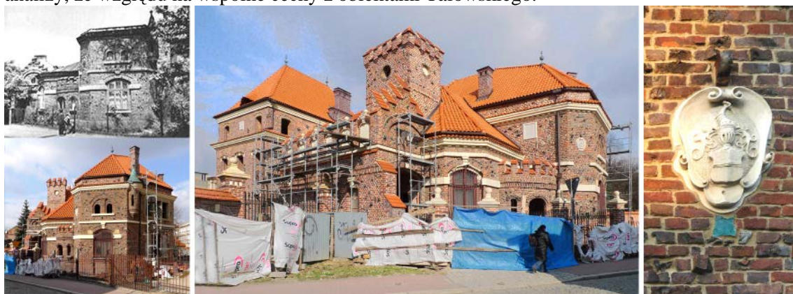
Ryc. 143. Willa Koci Zamek w Tarnowie – arch. Sz. Zaremba (1893) – po lewej stronie u góry – porównanie stanu pierwotnego i obecnego budynku; prace budowlano-adaptacyjne; detal kamienny – herb Kotwicz /fot. autora, 2010/
