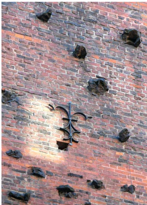
Ryc. 67. Fragment ściany kamienicy Pod Pajakiem /fot. autora, 2008/
