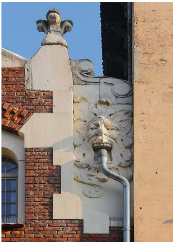
Ryc. 147. Podstacja elektryczna – malowniczy detal rzygacza /fot. autora, 2009/ Fig. 147. Electric substation – picturesque detail of gargoyle /photo by author, 2009/
