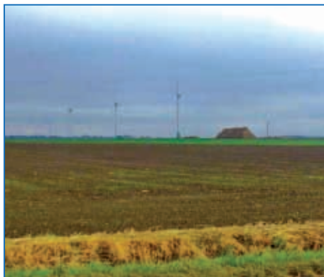
Fot. 36. Elektrownie wiatrowe w Jemielnicy Pic. 36. Wind Farm in Jemielnica
