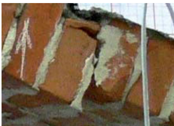
Rys. 6.3. Ścięcie połączenia między ceglami.
