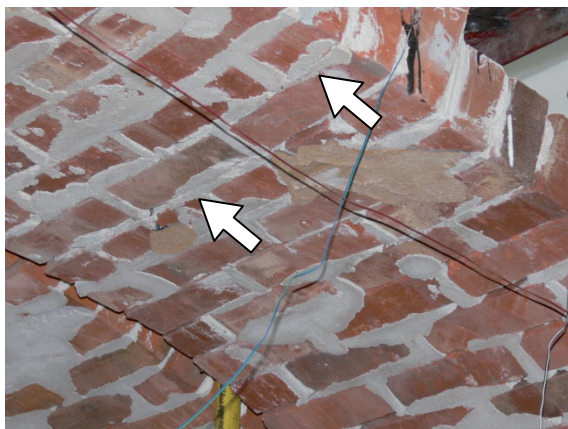
Rys. 4.146. Zarysowanie podniebienia łuku A5 (siła ok. 11 kN).
