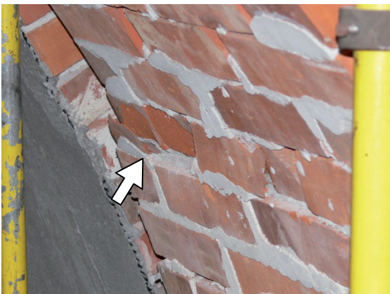
Rys. 4.167. Odspojenie fragmentów cegieł na podporze 'B' (siła ok. 15 kN).
