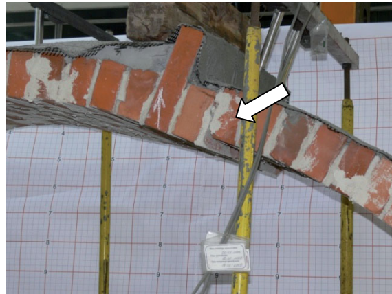
Rys. 4.81. Zarysowanie i ścięcie spoiny pod miejscem przyłożenia obciążenia (siła ok. 8 kN).
