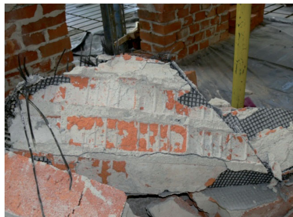
Rys. 4.88. Odspojenia siatki z włókna węglowego od zniszczonej konstrukcji łuku A2.
