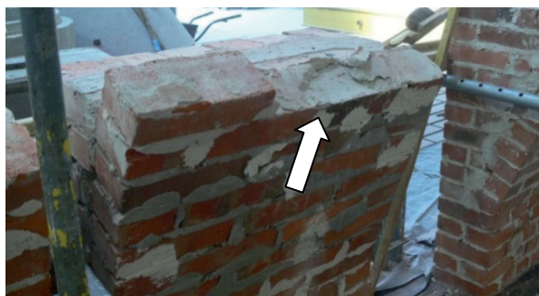
Rys. 4.68. Podpora A po zniszczeniu łuku A1.
