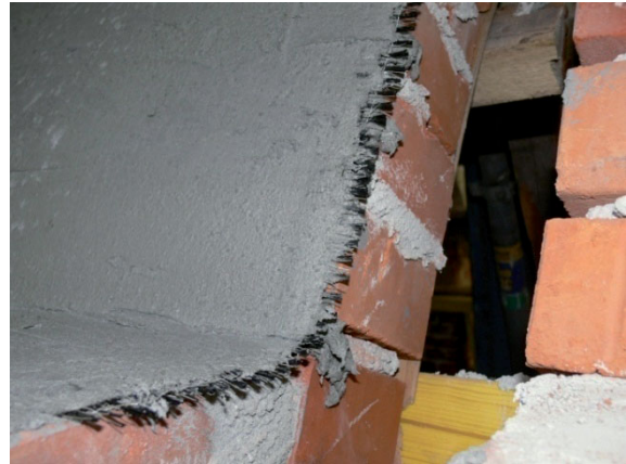
Rys. 4.79. Siatka z włókna węglowego wklejona w zaprawę mineralną.
