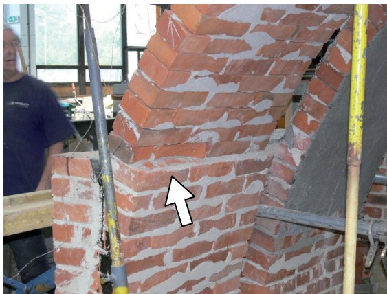
Rys. 4.169. Ścięcie na podporze 'A' (siła ok. 16,5 kN).
