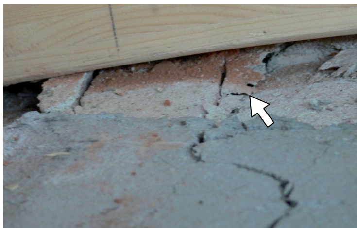
Rys. 4.193. Niszczenie łuku A7 (siła ok. 28 kN).
