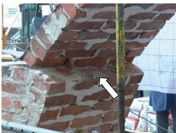
Rys. 4.109. Zniszczenie łuku - ścięcie spoin i zmiżdżenie cegieł w strefie podpory lewej 'A' (siła 26,675 kN).
