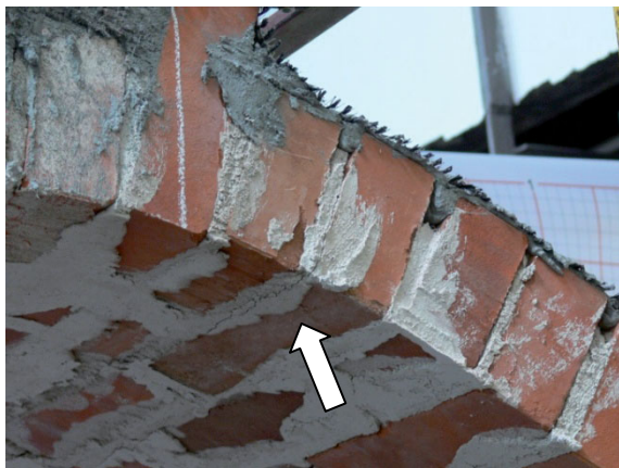
Rys. 4.105. Zarysowanie pod miejscem przyłożenia obciążenia (siła ok. 7 kN).
