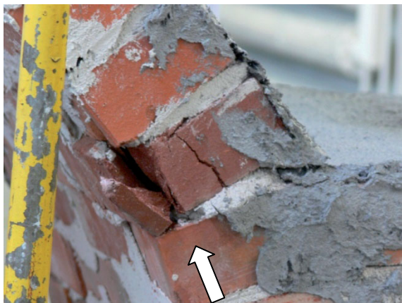
Rys. 4.107. Miażdżenie cegieł w podporze prawej 'B' (siła ok. 22,5 kN).
