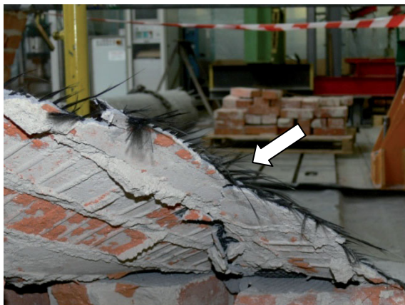
Rys. 4.89. Zniszczenie siatki z włókna węglowego, widoczne odspojenie zaprawy wraz z fragmentami cegieł od konstrukcji ceglanej.
