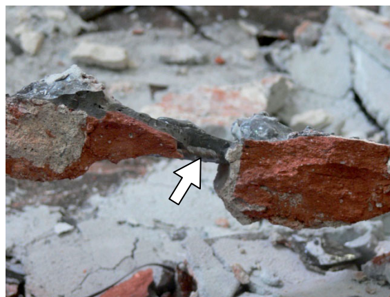
Rys. 4.150. Pręt stalowy z fragmentami przyklejonej cegły z łuku A5.
