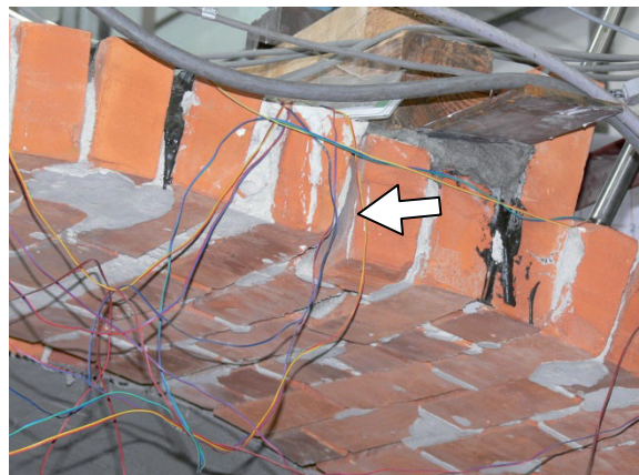
Rys. 4.168. Ścięcie pod miejscem przyłożenia obciążenia (siła ok. 16 kN).
