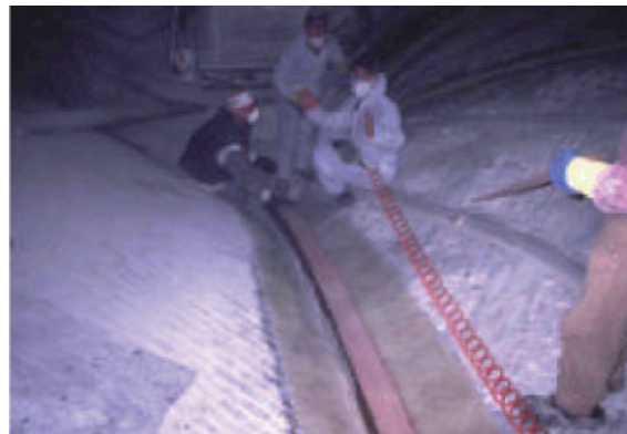
Rys. 3.127. Wzmocnianie żeber sklepień ceglanych w bazylice św. Franciszka w Asyżu przy pomocy włókien aramidowych, [60].
