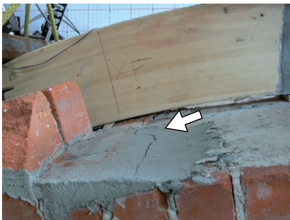
Rys. 4.191. Zarysowanie łuku A7 (siła ok. 25 kN).
