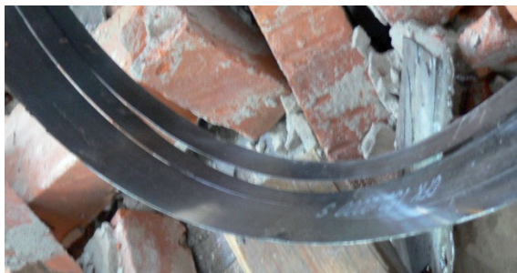
Rys. 4.178. Rozszczepienie taśmy FRP po zniszczeniu łuku A6.
