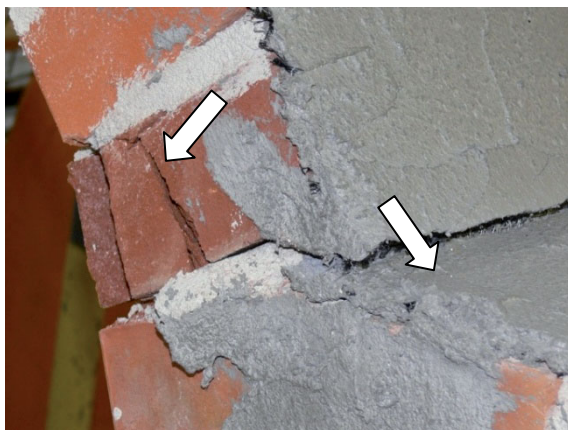
Rys. 4.111. Zmiażdżona cegła w podporze prawej 'B', widoczne rozerwanie statki wzmacniającej.
