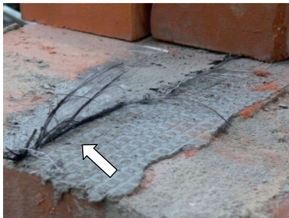
Rys. 4.90. Pozostałości siatki wzmacniającej na podporze lewej 'A'.
