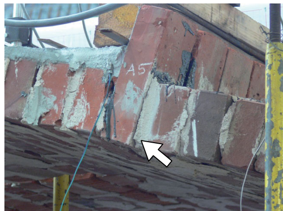
Rys. 4.147. Zarysowanie (tworzenie przegubu) w miejscu przyłożenia obciążenia (siła ok. 17 kN).
