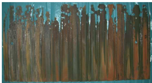
Rys. 12.5 Typowe przykłady zniszczenia blach emaliowanych po 4 latach eksploatacji.
