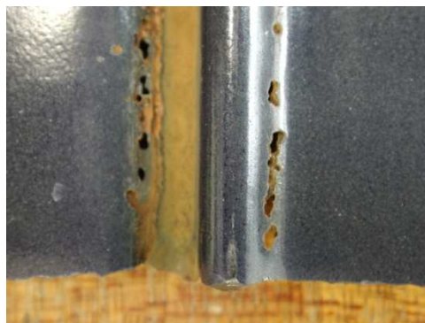
Rys. 12.7 Początkowe stadium niszczenia krawędzi blachy wymiennika z emalią – widoczne uszkodzenie w postaci perforacji na powierzchni przetłoczenia blachy.
