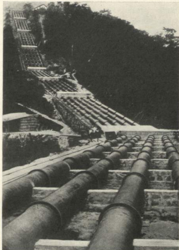
Abb. 1. Rohrleitungsanlage Santos (Brasilien)
