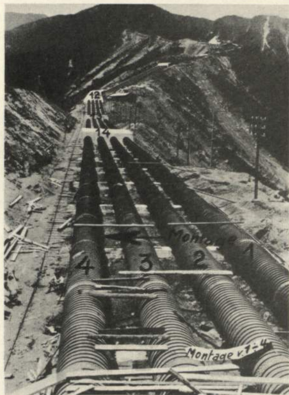
Abb. 36. Rohrleitung Fusenko (Japan)
