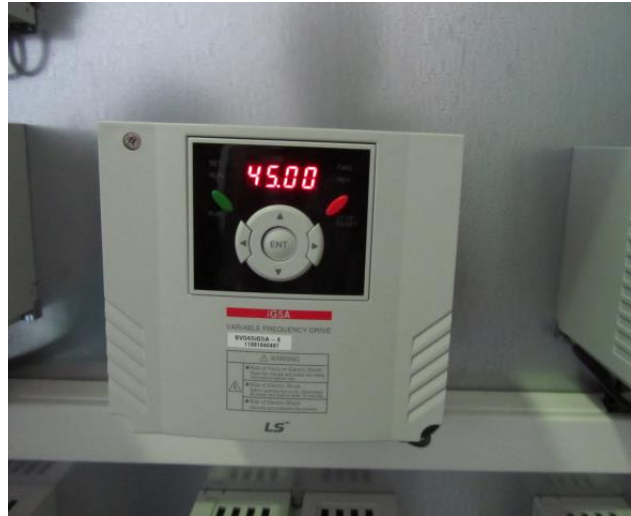
rys. 31. Falownik LG iG5A umożliwiający regulację prędkości obrotowej wentylatora
