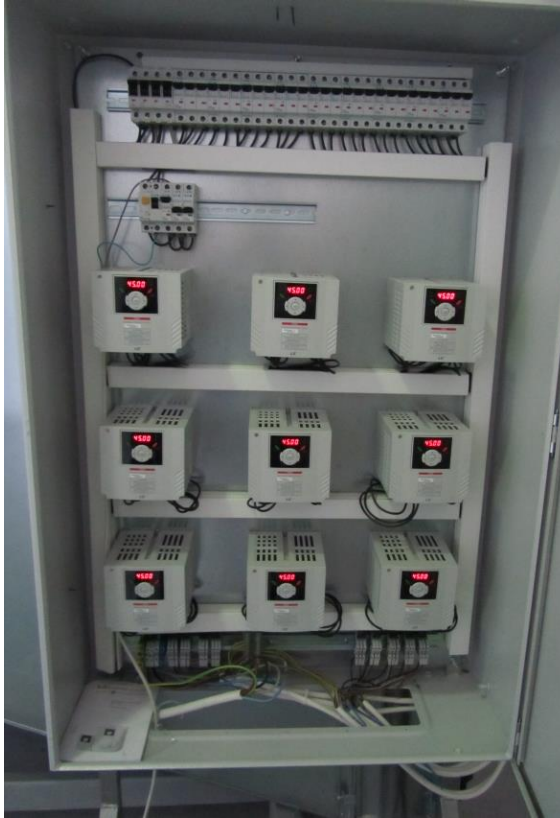
rys. 30. Szafa sterownicza tunelu aerodynamicznego
