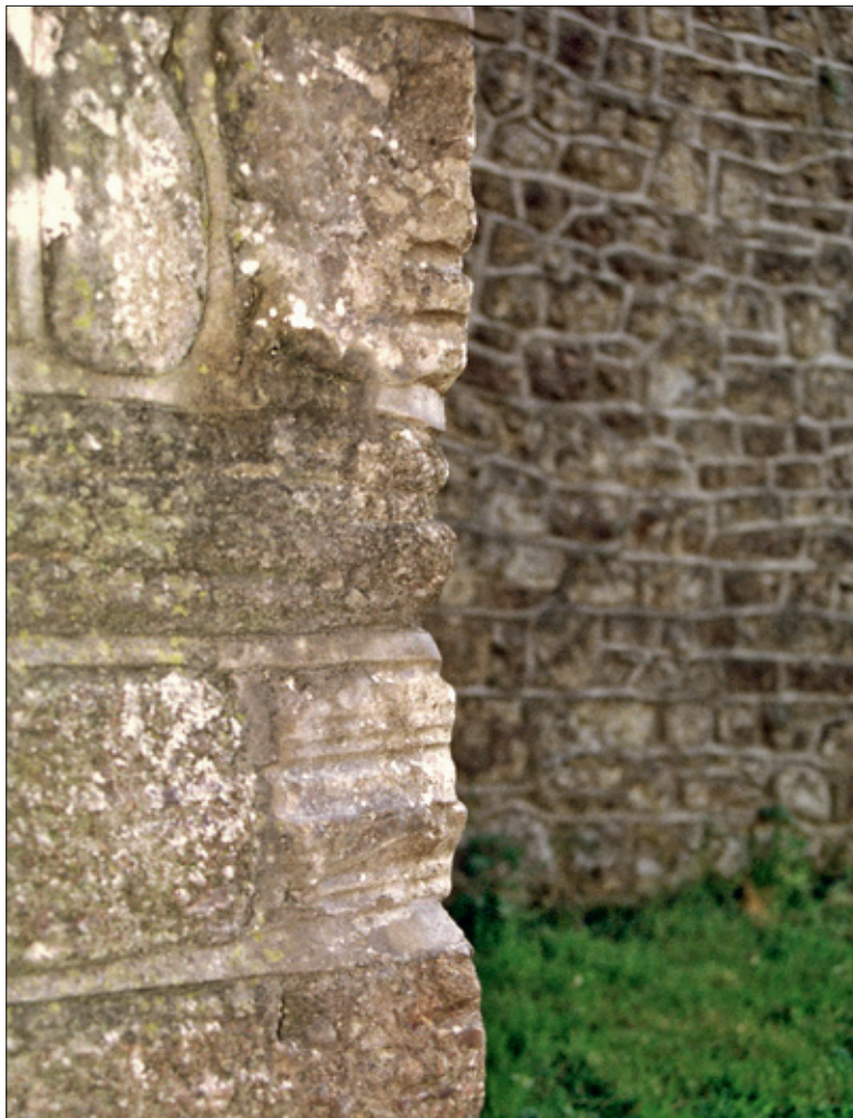
Robertstown , ślady po linach wytarte w kamiennej podporze pod mostem Binns
