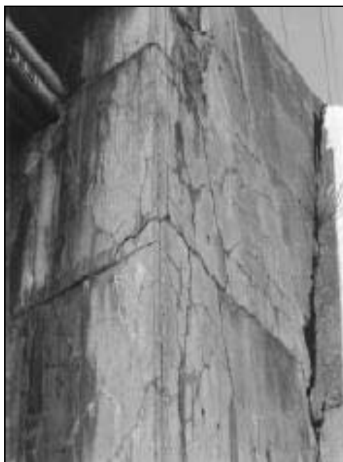
Rys. 4. Ściana oporowa. Pękanie i uszkodzenia powierzchni betonu na elementach betonowych konstrukcji wystawionych przez dłuższy czas na działanie wilgoci; niektóre pęknięcia wypełnione są żelem (RILEM TC 219 ACS, 2001)
