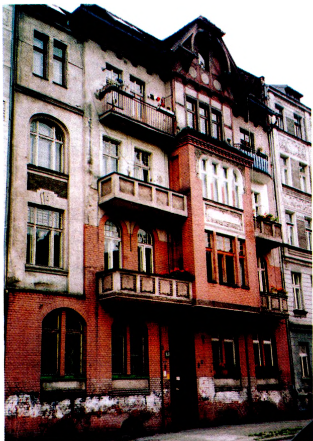
Ryc. 10. Wrocław, ul. Chemiczna 3. Stan z 1997 r. Elewacja z szachulcowym szczytem i drewnianym gzymsem wieńczącym. Fragmenty licowane cegłą pomalowane współcześnie
