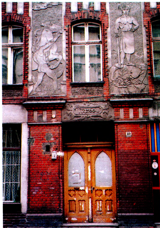
Ryc. 11. Wrocław, ul. św. Antoniego 40. Stan z 1997 r. Secesyjna kamienica ceglano-tynkowana z bogatą dekoracją z dwubarwnego sgraffita
