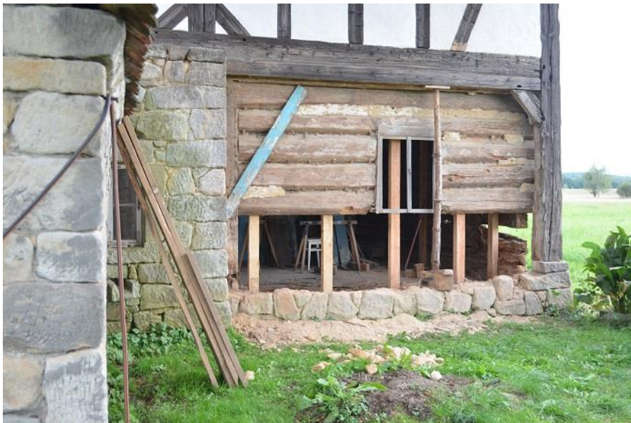
Fot. 9. Rekonstrukcja ściany izby zrębowej w domu przysłupowym – w trakcie remontu. Wyrzucono zmurszałe belki i wyczyszczono ścianę.
