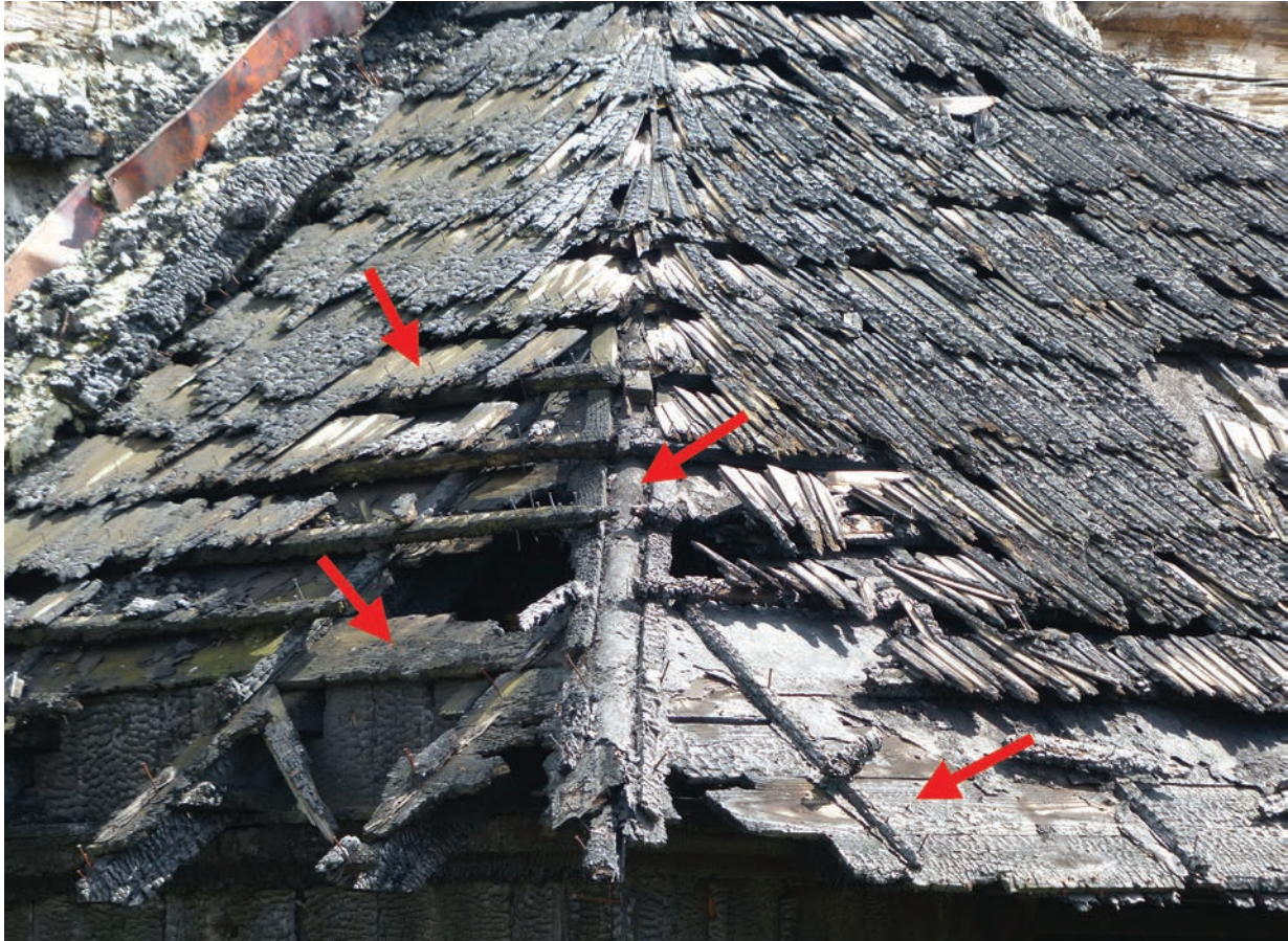
Il. 4. Mieszki – pomimo znacznych uszkodzeń możliwa jest analiza układu i materiału poszycia dachów nad kruchtami oraz sposobu jego ułożenia (fot. D. Mączyński)
