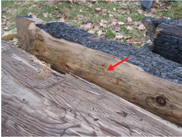
Il. 1. Pogorzeliisko po XVII-wiecznym kościele w Grabówce – odnalezione inskrypcje na belkach konstrukcyjnych ścian (fot. D. Mączyński)
