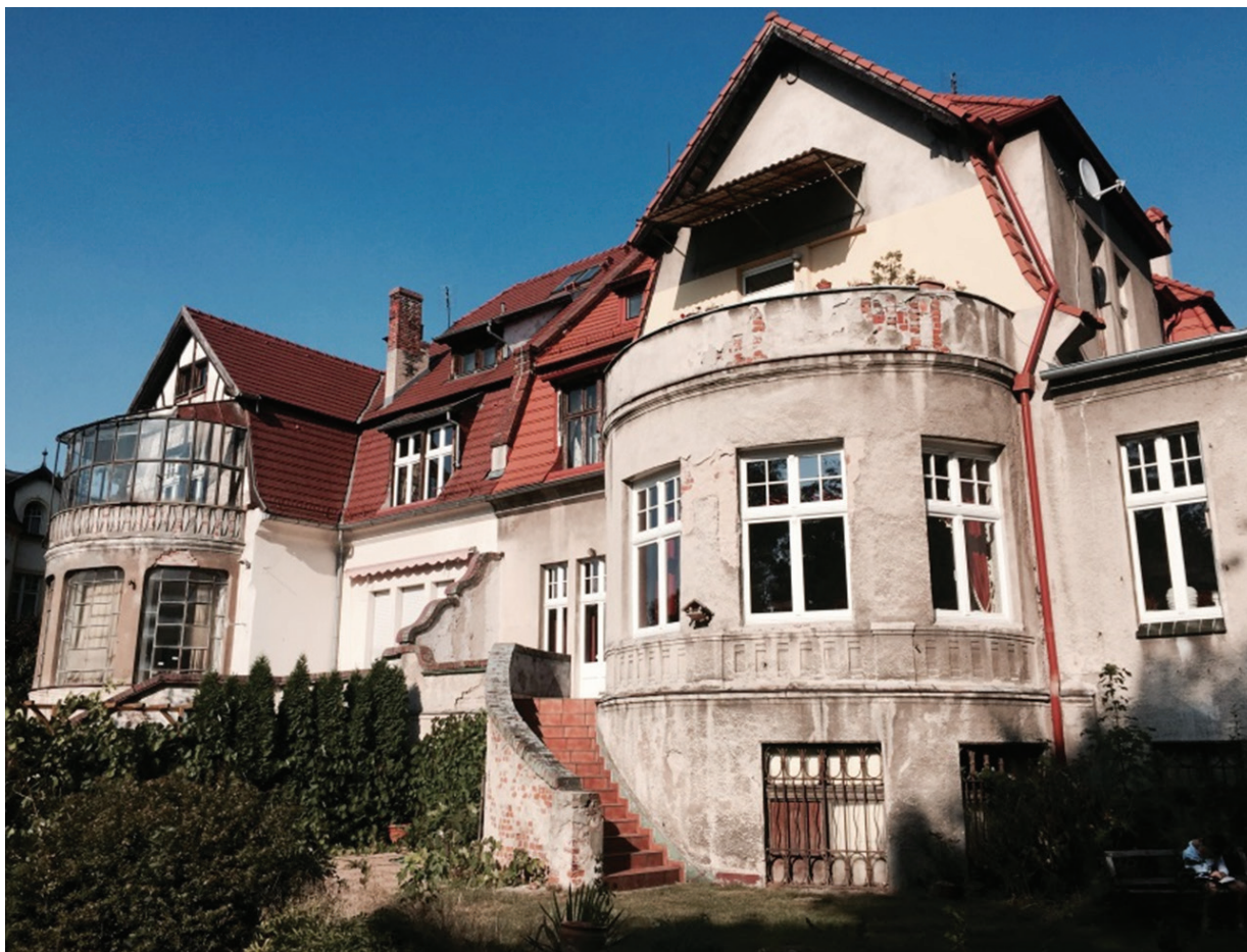
Il. 6. Willa przy ul. Parkowej – elewacja ogrodowa. Pomimo zachowania oryginalnych, historycznych elementów, takich jak wykusze czy schody prowadzące na parter budynku, widoczny jest znaczny stopień dewastacji obiektu. Stan obecny (fot. J. Olesińska)
