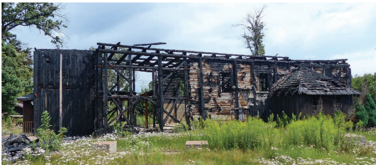
Il. 3. Kościół w Mileszkach z 1766 r., spalony w 2015 r. – stan po pożarze (fot. D. Mączyński)
