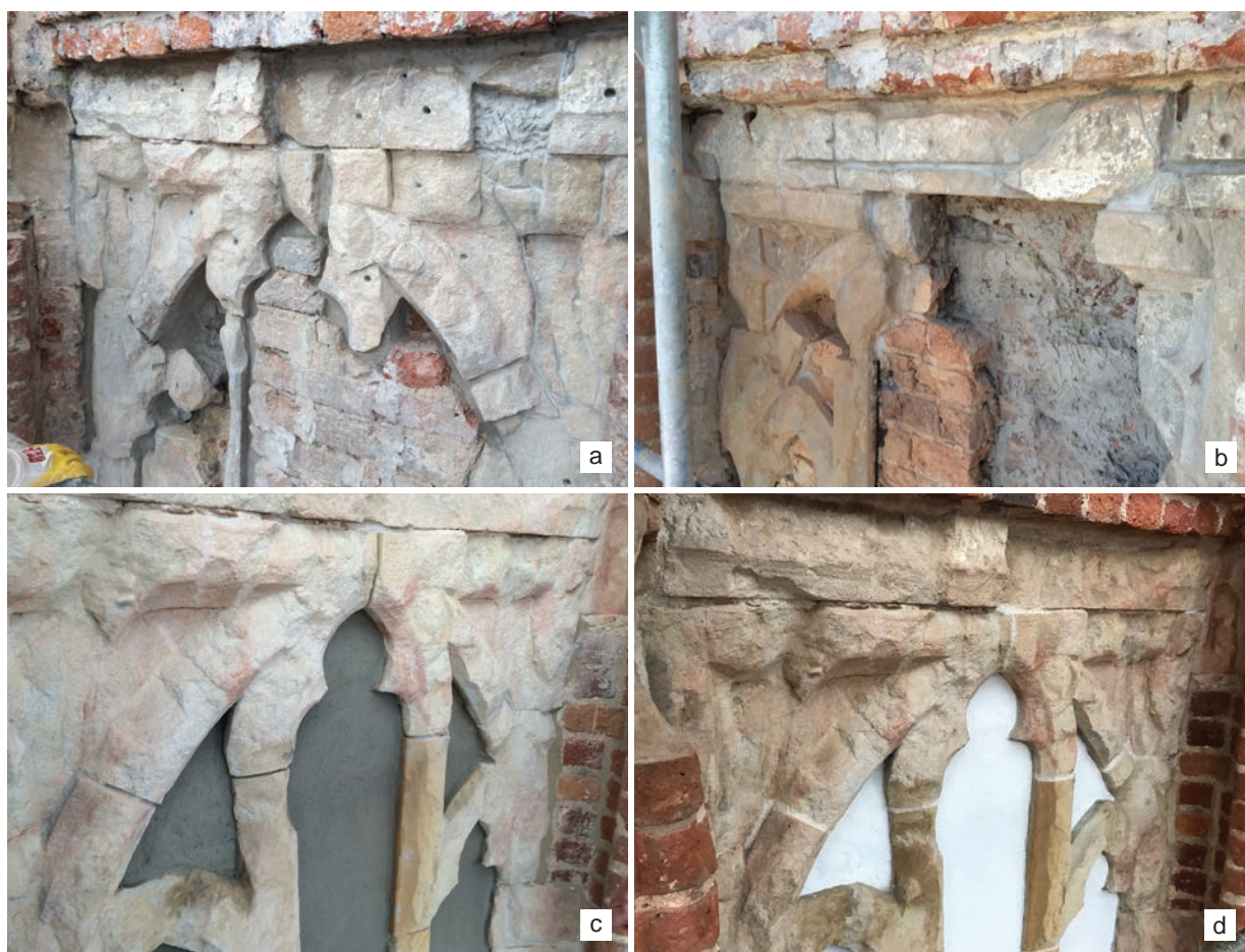
Il. 7. Kozuchów, kościół pw. MB Gromnicznej, wieża, maswerk drugiej kondygnacji ośmioboku; stan: a – po skuciu tynków, b – po usunięciu części przemurowań, c – po wykonaniu uzupełnień i tynków na zamurowaniu, d – po zakończeniu prac (fot. A. Legendziewicz)
