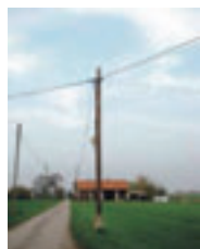
Fot. 226. Słupy energetyczne i telekomunikacyjne przy ulicy Polnej.
