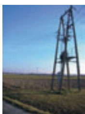
Fot. 223. Transformator przy ulicy Długiej.
