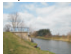
Fot. 6 Zerwany most na końcu ulicy Kanałowej
