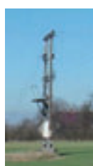
Fot. 224. Transformator, przysiółek Jama.
