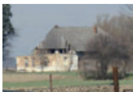
Fot. 52. Ruina budynku mieszkalnego, ul. Krótka 9.
