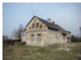
Fot. 50. Budynek mieszkalny sprzed 1945 roku w złym stanie technicznym, posesja obok ul. Świerczewskiego 3.
