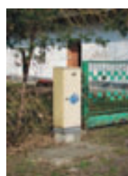
Fot. 227. Skrzynka telekomunikacyjna przy ulicy Odrzańskiej 24.
