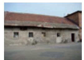
Fot. 51. Budynek gospodarczy w złym stanie technicznym, ul. Świerczewskiego 3.
