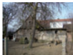
Fot. 95. Drewniane i murowane małe budynki gospodarcze w złym stanie technicznym, ul. Świerzewskiego 11.
