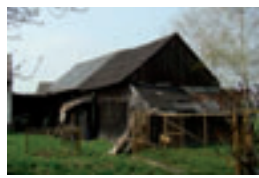
Fot. 94. Budynki gospodarcze w złym stanie technicznym, ul. Odrzańska 25.
