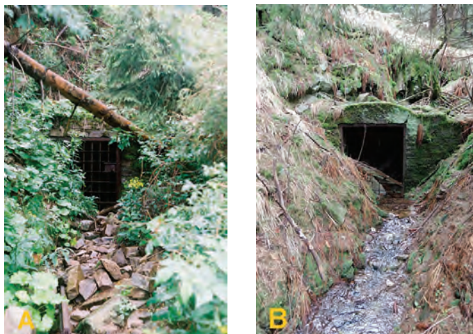
Ryc. 26. Okno sztolni nr 17: A – według stanu z 15.07.1996 r. (fot. R. Borzęcki), B – według stanu z 8.04.2017 r. (fot. D. Wójcik)
