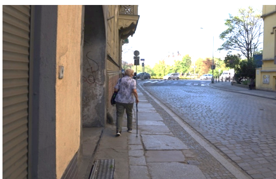
Rys. 42. Nierówna nawierzchnia chodnika znacząco utrudnia lub uniemożliwia korzystanie z niego, ul. Dworcowa. Wrocław (zdj. autor)
