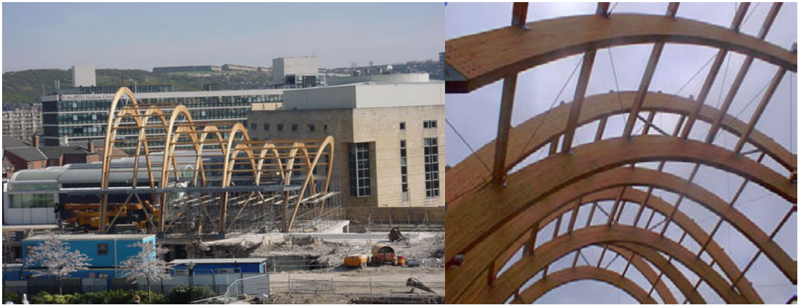
Rys. 5.101. The Sheffield Winter Gardens, Wielka Brytania. Architektura: Pringle Richards Sharratt Architects. Konstrukcja: Buro Happold, [354].
