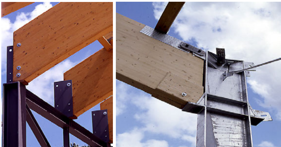
Rys.7.20. Poparcie belki z drewna klejonego na słupie stalowym. Słup stalowy daje możliwości spawania elementów stalowych, na których osadza się dźwigary bezpośrednio na montażu przed wykonaniem ostatecznego połączenia, [335].
