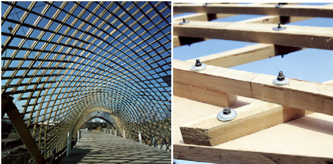
Rys. 5.144. Hala wielofunkcyjna w Mannheim. Architektura: Carlfried Mutschler + Partner, J. Langner, Mannheim. Konstrukcja: Frei Otto, Ted Happold, Ian Liddell, Ove Arup & Partners, [335].
